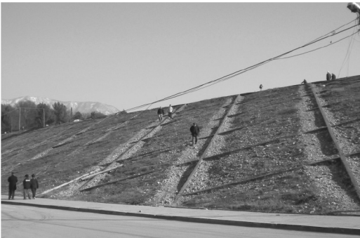
Fig. 7.33 a) Përforcimi i digës së Liqenit të Madh, Tiranë, me breza betoni
