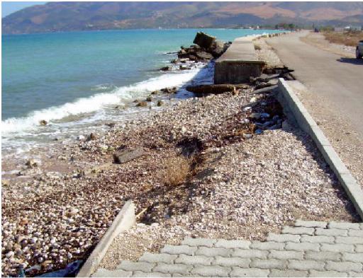
Fig. 2.78 Dëmtimi i rrugës anëdetit afër Pashalimanit
