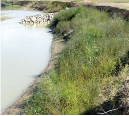
Fig.2.97 Mbjellja e shelgut në vend-depozitimet anës bregut të lumit, si dhe ndërtimi i breshkave (pendë të vogla me gurë).
