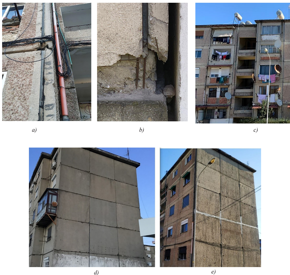
Figura 35. Gjendja para-tërmetit e ndërtesave me pllaka beton arme të parafabrikuara në zonën e Kombinatit, Tiranë: a) përkeqësim i paneleve dhe lidhjeve të tyre; b) gërryerja e betonit dhe korrozioni i armaturës në bazën e murit; c) rinovimi i murit të jashtëm – mbushje murature; d) ndërtimi i një ballkoni të ri (niveli i katit të tretë) dhe e) fuga horizontale të mbushura në nivelin e katit të dytë.
