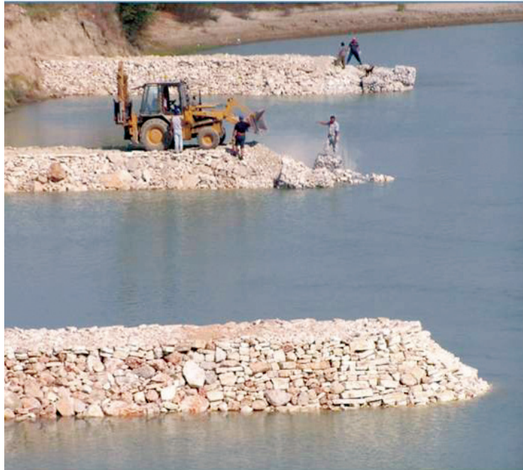
(Figura 45) Penela mbrojtëse në lumin e Vjosës 38
